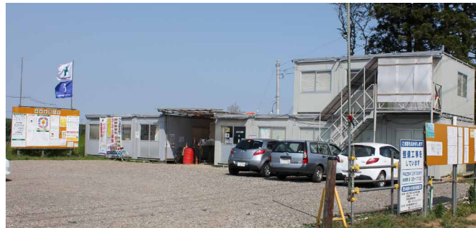
現場事務所。有線ネットワークで本社・支店と接続されている
