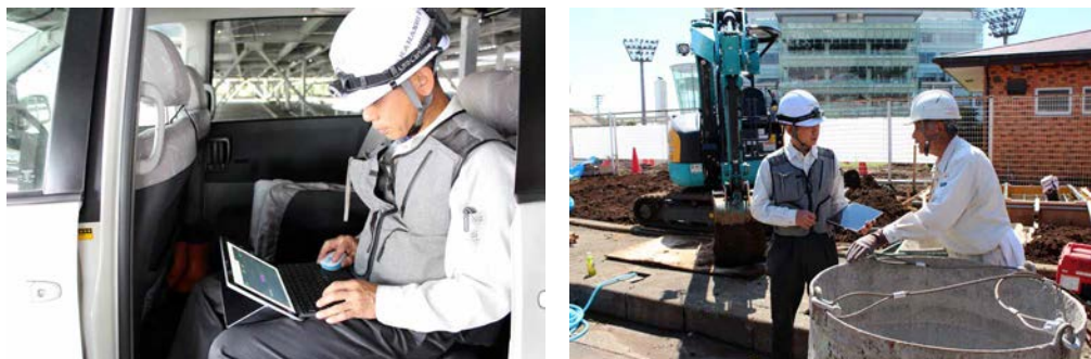
図面の変更連絡なども「Surface 3」からリアルタイムに確認。マウスとキーボードも使えるので、隙間時間で図面変更も可能（左）。変更後の図面を「Surface 3」を見せながら職人へ指示。拡大できるので見やすい（右）
